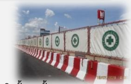
ติดตั้งแผงกัน (Concrete Barrier) แสดงขอบเขตพื้นที่ก่อสร้าง
